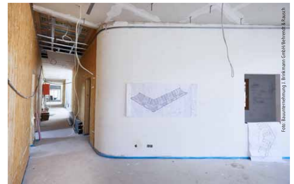
Runde Ecke. Die gebogene Wand hat einen Innenradius von etwa 950 bis 1.000 mm. Beplankt wurde sie mit der biegsamen GK-Form 6 (Rigips). Für die Anschlüsse wurde die Anschlussdichtung Filz des Herstellers verwendet.
